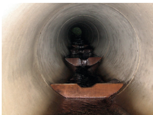
Déflecteurs dans le pertuis du Ruisseau de Waity
